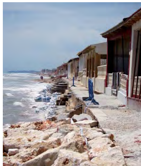
Playa Babilonia er en strand full av hinder. Ingeniør Codornius bygninger fra 1950-tallet har blitt skadet. Kommunen som eier alt her, har leid ut området frem til 2018. Steiner og sekker med armert betong prøver å redusere omfanget av de fremtidige skader.
